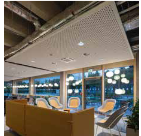
Die Baukonstruktion bleibt überwiegend unverkleidet. Die technische Gebäudeausrüstung ist offen geführt und einfach zugänglich.
